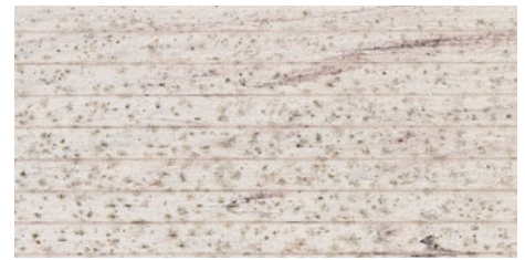
Stockflecken/Schimmel auf der Oberfläche
