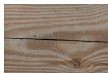
Spannungsrisse durch die Holztrocknung
